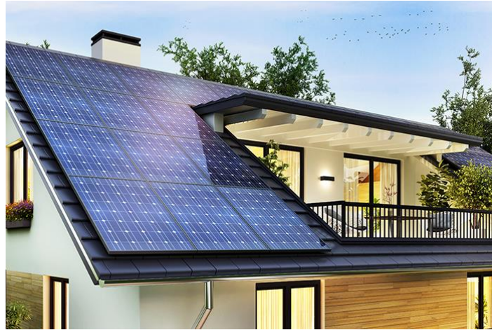
شكل (10) تركيب الألواح الكهروضوئية على الاسقف المائلة (36) .
